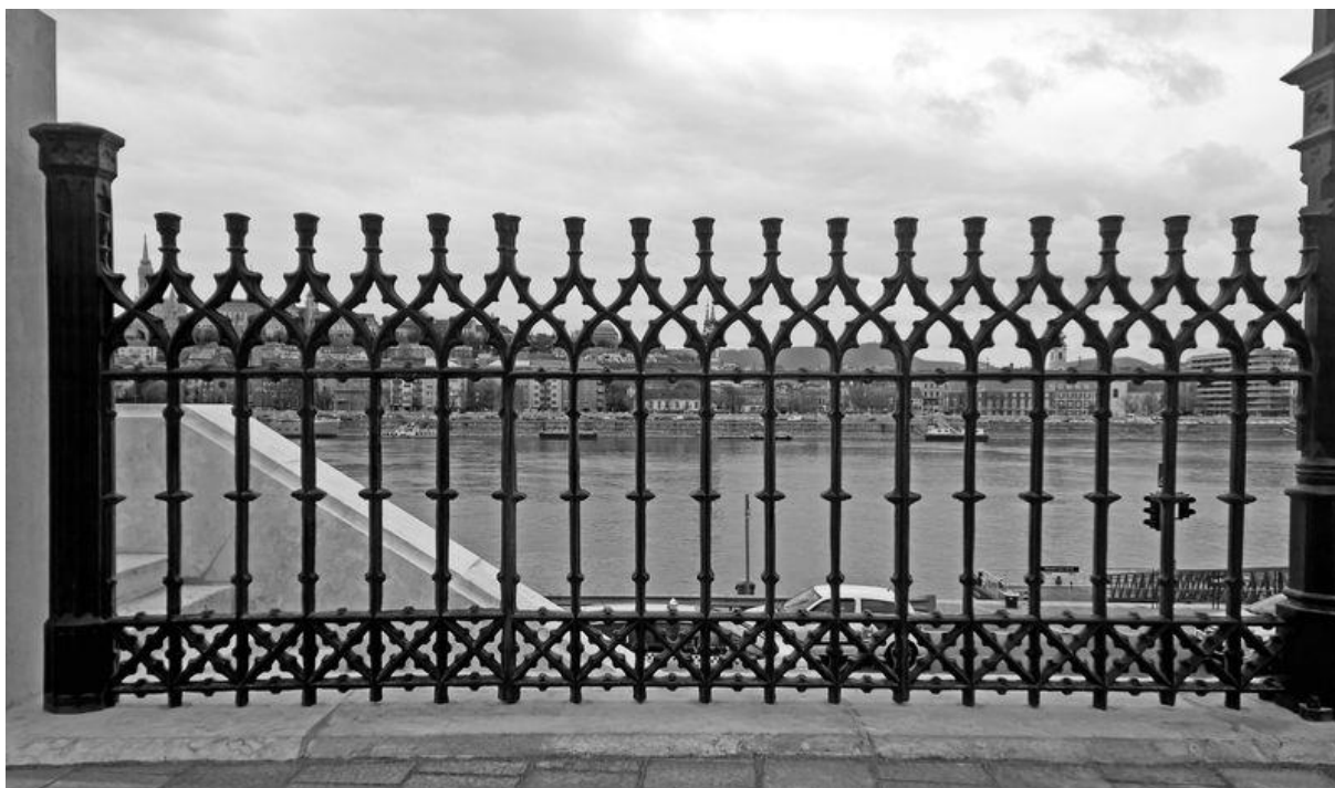
1. kép. A rakparti öntöttvas korlát a 2015 őszi restaurálást és részleges rekonstrukciót követően (a szerző saját felvétele)
